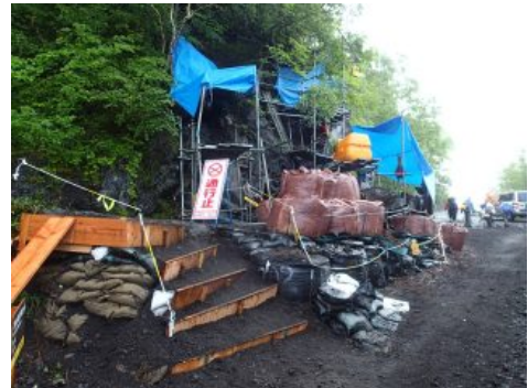
吉田ルート5合目泉ヶ滝落石状況 (撮影: 房村)
